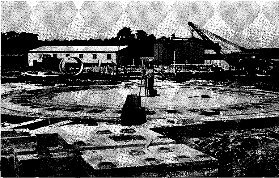
Abb. 5 Das fertige Fundament. Auf dem Schachtmittelpunkt steht das Meßgerät. Die Ansatzpunkte für die Bohrlöcher sind mit Holz abgedeckt.
